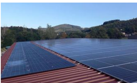
Mise en service de la deuxième centrale photovoltaïque à Châteauneuf de Vernoux (07)
